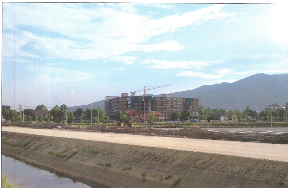
Au premier plan, la route en voie d'achèvement du nouveau Palais des Congrès avec dans le prolongement un des nouveaux projets immobiliers de ce quartier neuf, le Resort.
